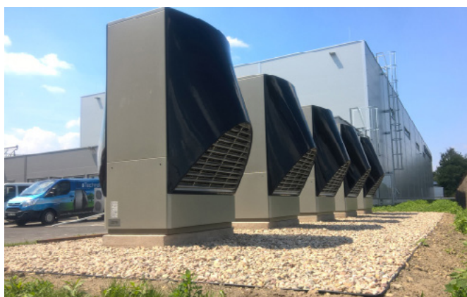
Průmyslová hala, venkovní systém vzduch/voda
